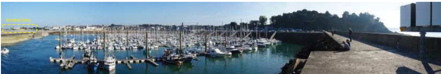
Entité 1 « digue maritime des Sablons » vue depuis l'extrémité de la digue à marée basse
